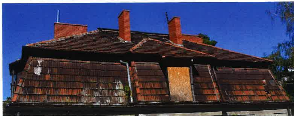
II. 26 Dach budynku na górnej połaci układ dachówki w koronkę, na dolnej, wtórna dachówka
