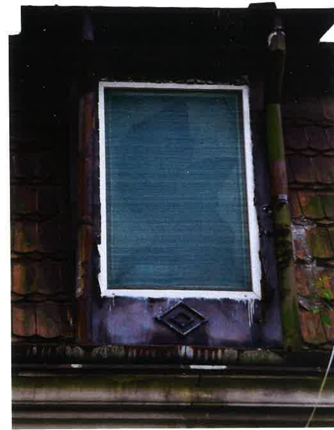
II. 24 Wtórne okno na poddaszu z oryginalną obróbką blacharską
